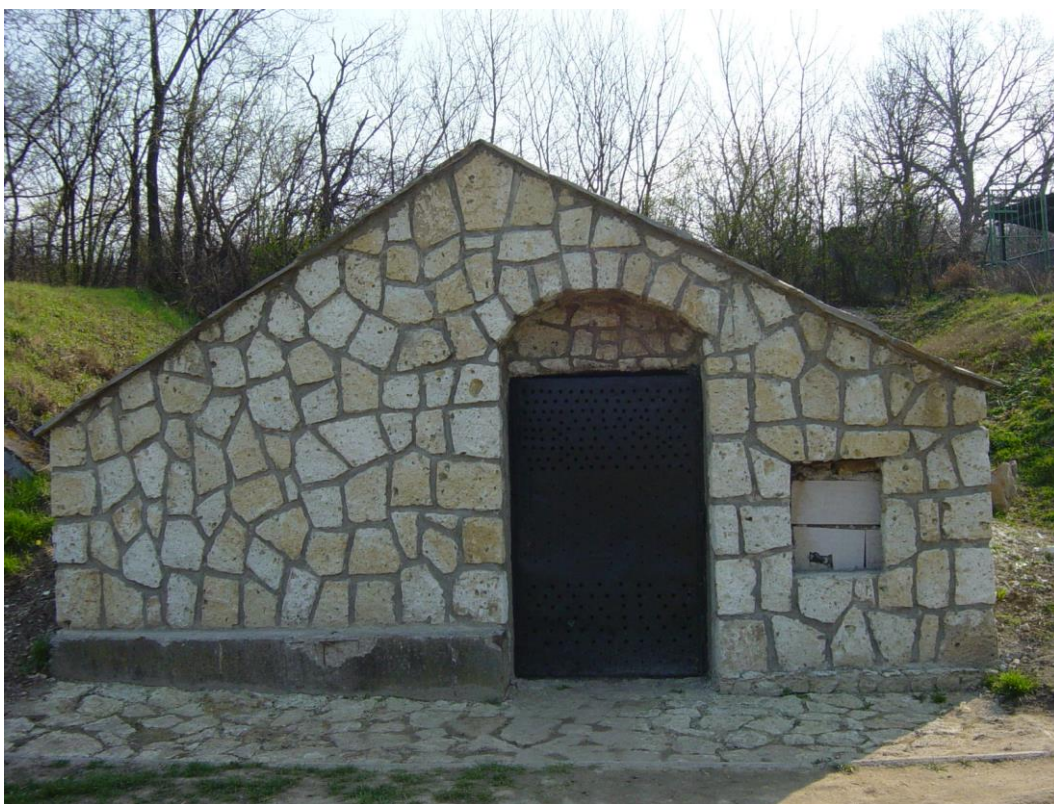
OBR. 32 NOVODOBÝ ASYMETRICKY NEVHODNE UPRAVENÝ PORTÁL PIVNICE Č. 29
