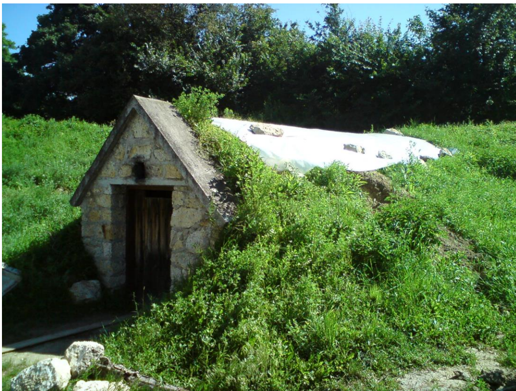
OBR. 31 PORTÁL PIVNICE Č. 30, STAV PO PREBORNÍ KLENBY VSTUPNÉHO ŽRIEDLA PO VÝDATNÝCH DAŽDOCH V MÁJI 2010
